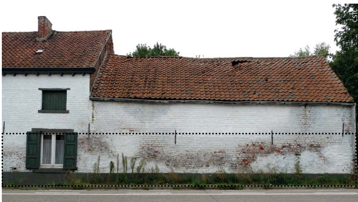
Fig. 3 Humidité ascensionnelle flagrante (encadrée d'un pointillé noir) : ce mur dépourvu de membrane anticapillaire à sa base a absorbé l'eau du sol sur un bon mètre de haut.
